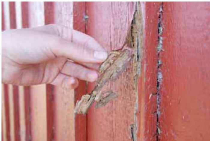
Akrylatfärg bildar ett tätt ytskikt - fasaden lider av rötskador och skadedjur
