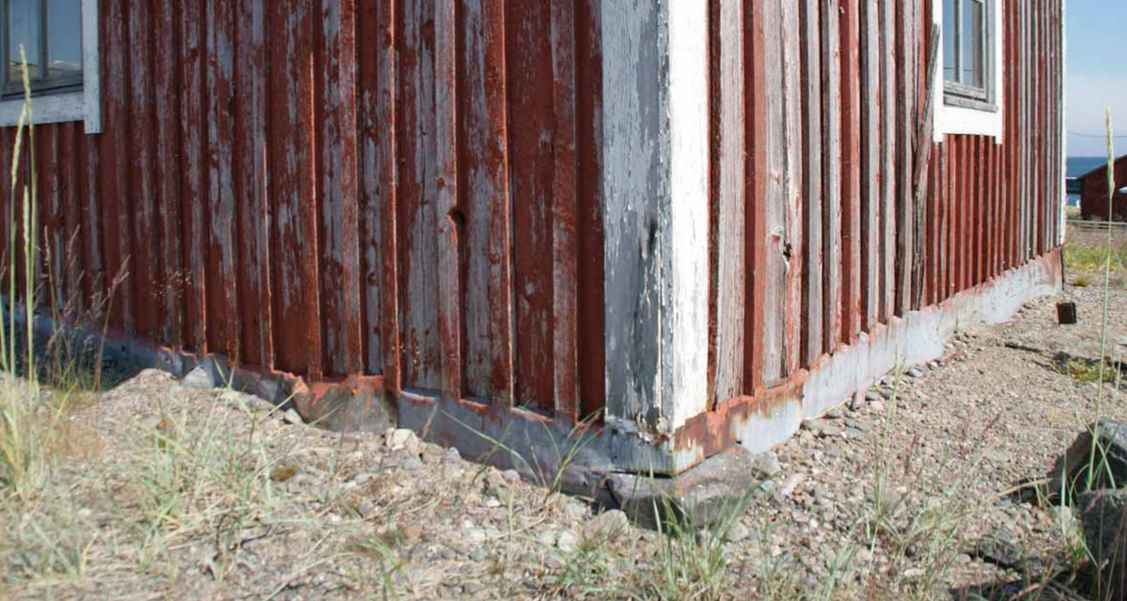
Plåten förorsakar skada genom att hindra grundens ventilation. Det leds även in vatten mellan fasaden och plåten. Pelti aiheuttaa vahinkoa estämällä alapohjan tuulettumisen. Julkisivua pitkin valuva vesi valuu suoraan pellin sisäpuolelle.
