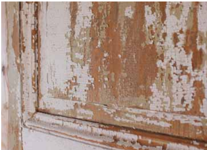
Åldrad krakelerad linoljafärg Vanheneva pellavaöljymaalii krakeloi
